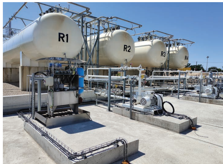
Installations de l'usine SOBEGAL
